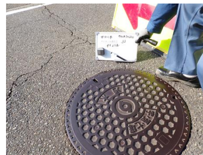
写真-3 かほく市 消散弁が開放したマンホールの浮上調査状況
