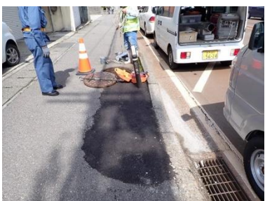
写真-4 金沢市 液状化による路面沈下補修と浮上なしの人孔
