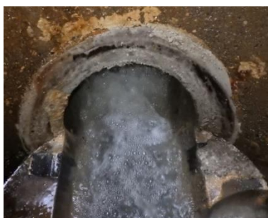
写真-1 金沢市 既設人孔耐震化工法の地震後の状況
