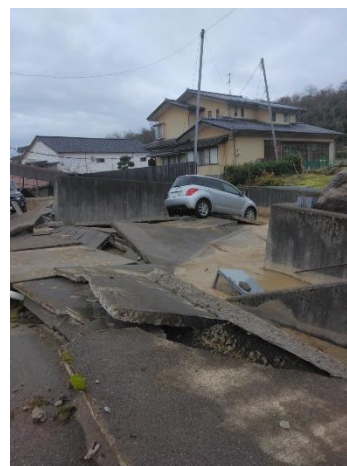
内灘町の側方流動の惨状
